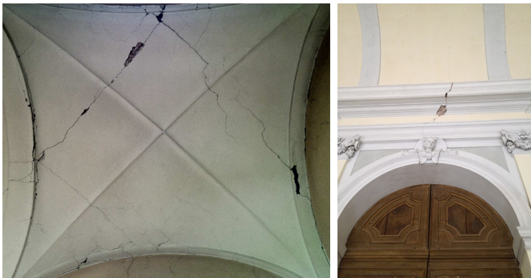
3. Sequenza di fotografie che illustrano i danni subiti dal fabbricato in seguito al terremoto. La foto a sinistra mostra la condizione di rischio durante il rilievo.
